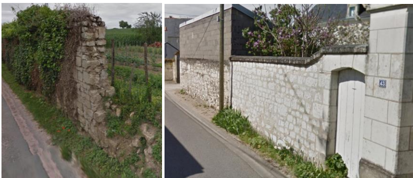
Mur à l'abandon menaçant de s'effondrer à gauche (Candes-St-Martin) et exemple de rénovation de mur de clôture à droite (Savigny-en-Véron)
